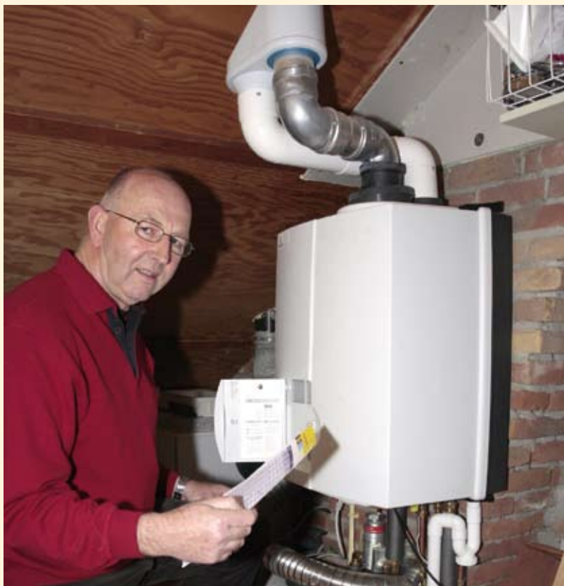
Nieuwere cv-ketels vragen minder onderhoud waardoor slechts één keer in de twee jaar onderhoud nodig is. Hierdoor wordt ook de overlast voor u als bewoner beperkt.
